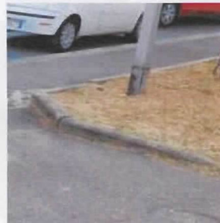
Attuale attacco tra il cordolo lungo il marciapiede e il cordolo del vialetto
