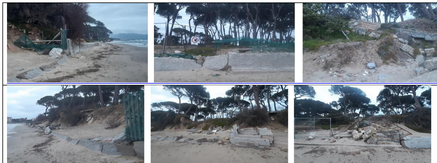
Ciò che resta delle opere antierosione (ingegneria rigida) sulla spiaggia tra Torre Mozza e Baia Toscana (Piombino)
